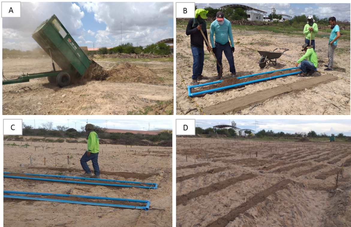
Figura 3. Estabelecimento das parcelas e condicionamento do solo. (A) Deposição do solo transposto na área de estudo; (B) e (C) Estabelecimento das faixas contínuas; (D) Parcelas condicionadas.
